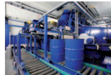
De nieuwe meet- en betonbemonsteringsinstallatie in gebouw 102.
